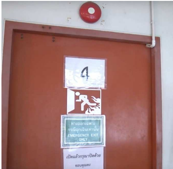
รูปที่ 12 ประตูฉุกเฉินและป้ายเตือนเพื่อรักษาความปลอดภัยในอาคาร
