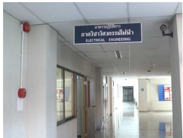
รูปที่ 11 ป้ายแจ้งเตือน ทางออก ระบบอัคคีภัย ประตูดูกล้อง CCTV
